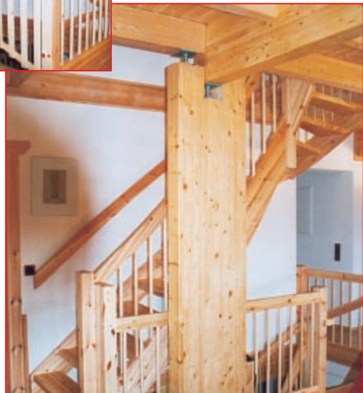
Schwere Stützpfosten und Justierschrauben übertragen die Last der Dachkonstruktion auf die Kellerdecke.
