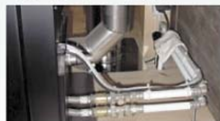
60% der Heizenergie wird an den Pufferspeicher, 40% an die Raumluft abgegeben.
