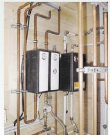
Die Steuerungseinheit regelt die Versorgung des 800 Liter Pufferspeicher.
